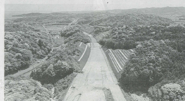
【事務所長表彰】 登録基幹技能者：令和4年度大田静間道路静間地区法面工事 (森山靖)
